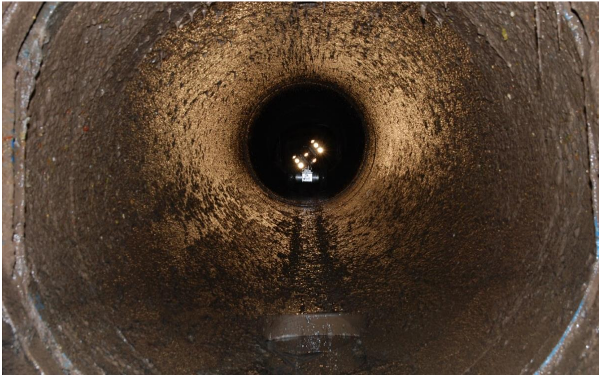
Kamerabefahrung im Kanal
